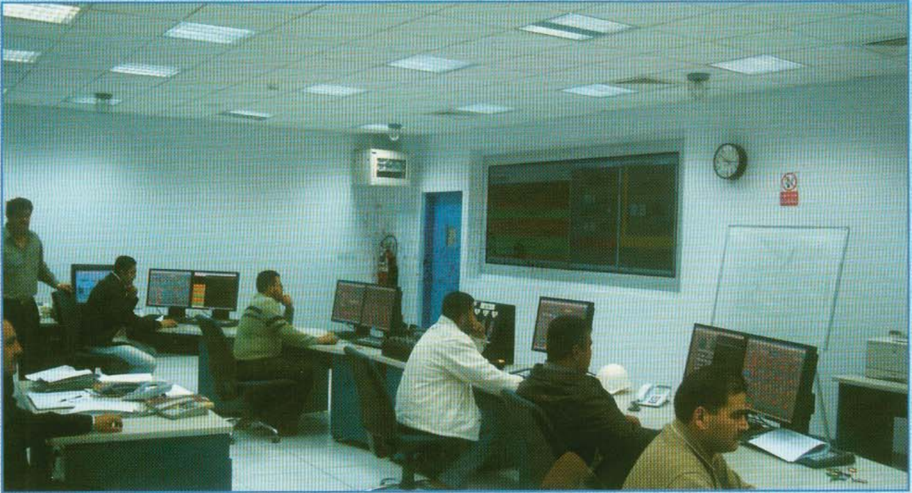
غرفة المراقبة والتحكم - محطة السمرا لتوليد الكهرباء
