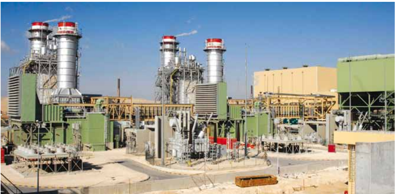
محطة السمرا لتوليد الكهرباء
